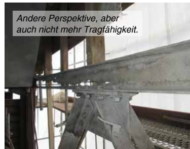
„Tragfähiger“ Rest eines Trägers nach dem Sandstrahlen.
