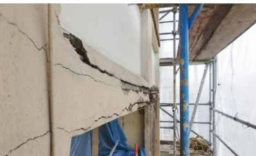
Stark beschädigter Träger eines innenliegenden Balkons
