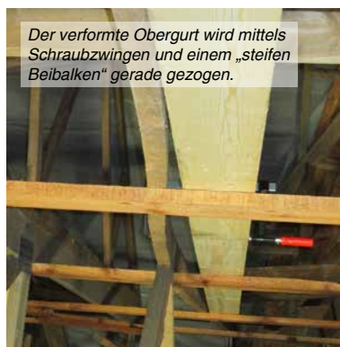
Gut sichtbare horizontale Auslenkung des Obergurtes bei der Bauwerksinspektion.
